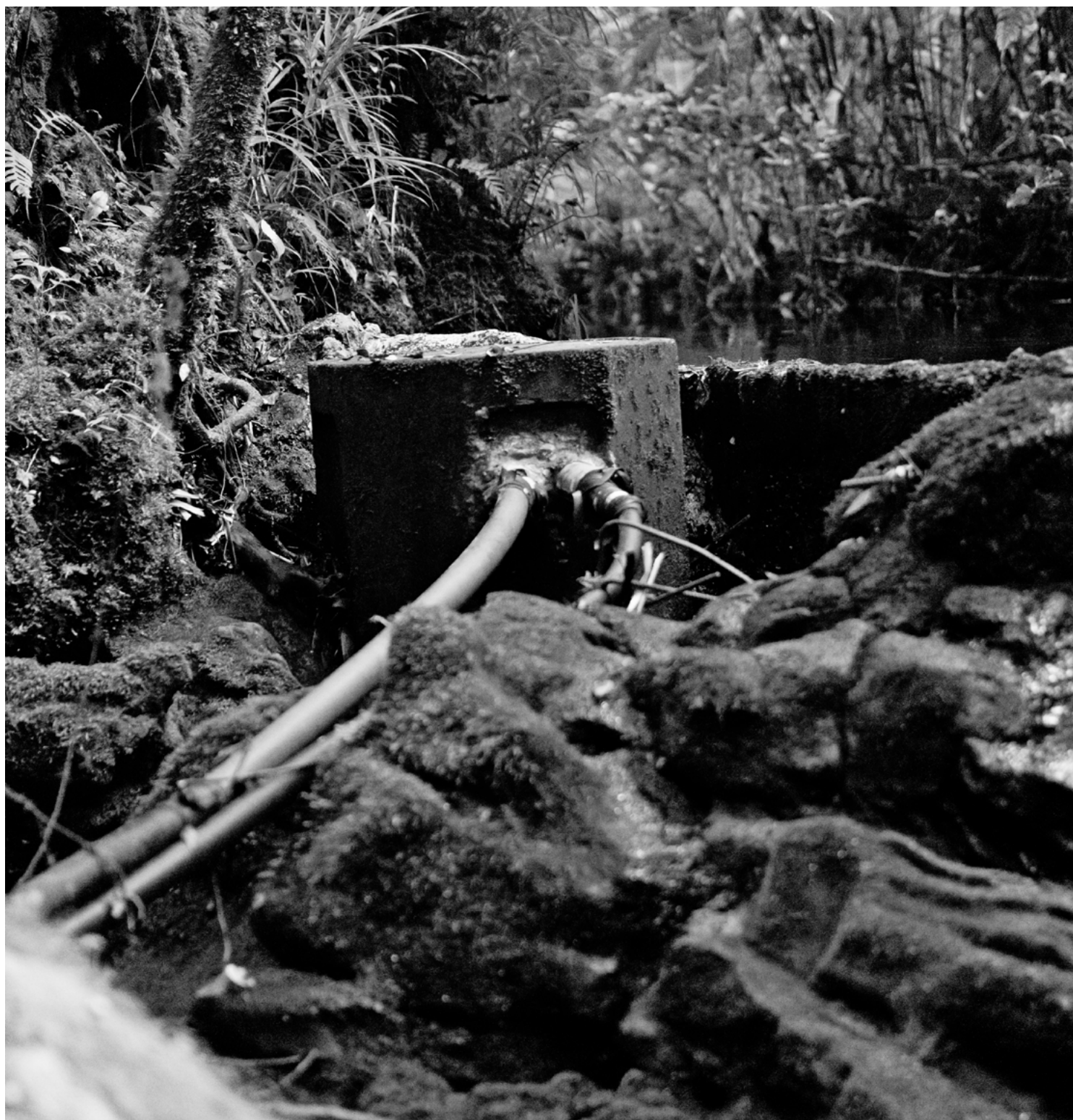
Tubería de Agua improvisada. Fotografía por Diego Sánchez.
